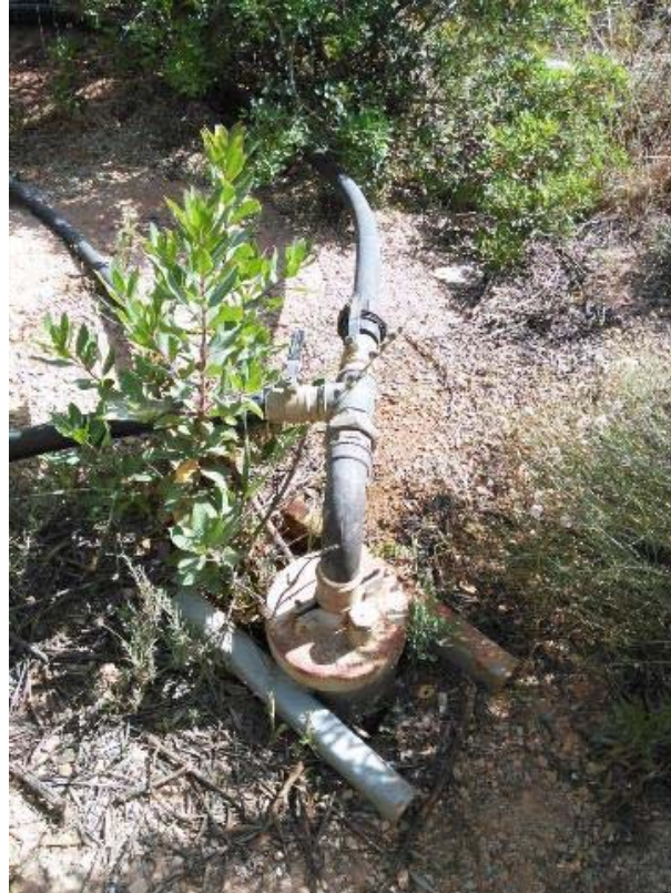
Figura III.30 – Furo de captação F1
